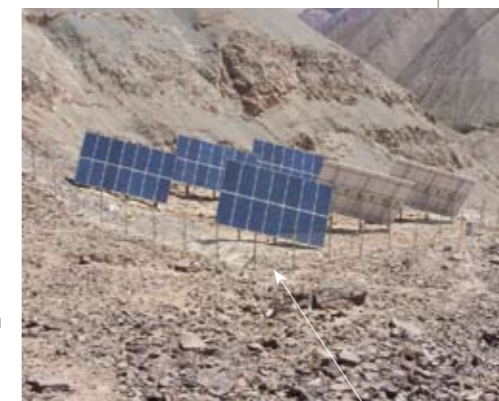
▲ Paneles solares proveen de energía renovable a la comunidad de Huatacondo
